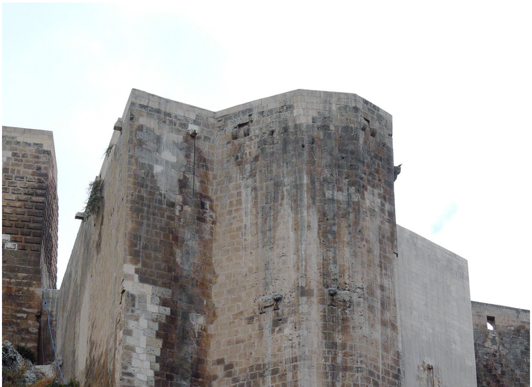
Figura 9. La ricostruzione del macro-periodo 5, torre 4 del sistema di accesso, da nord (foto: C. Tonghini)
