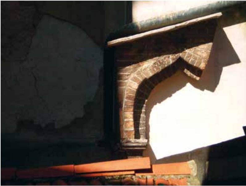
1. Venezia, Chiesa di San Bartolomeo, l'angolo della cappella della Madonna del Rosario e il muro soprastante la sacrestia maggiore. Particolare dell'archetto inflesso lungo l'antico spiovente del tetto della cappella della Madonna del Rosario
