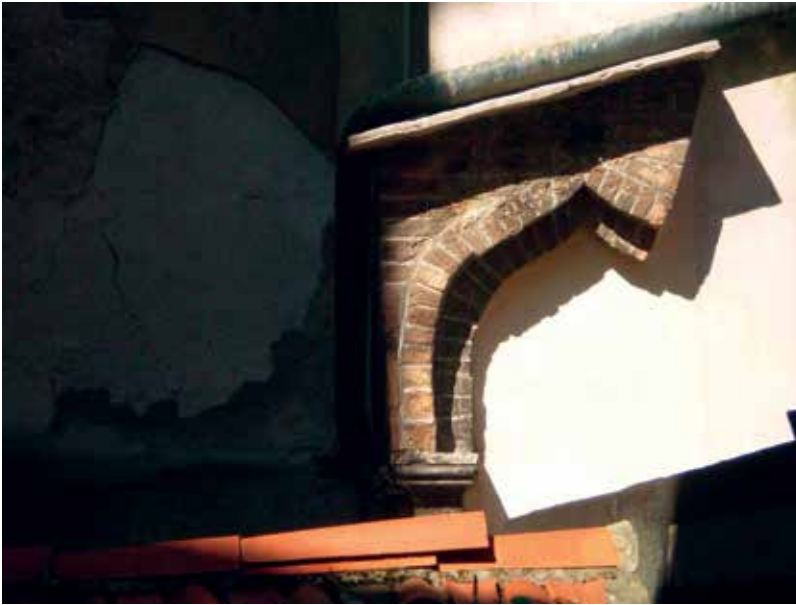
1. Venezia, Chiesa di San Bartolomeo, l'angolo della cappella della Madonna del Rosario e il muro soprastante la sacrestia maggiore. Particolare dell'archetto inflesso lungo l'antico spiovente del tetto della cappella della Madonna del Rosario
